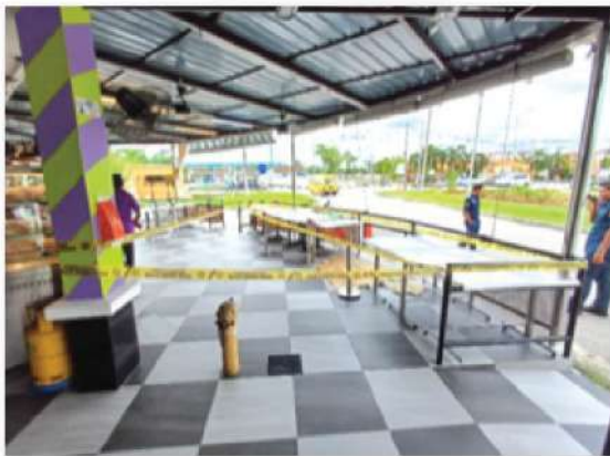
Binaan tambahan bumbung tanpa kebenaran di atas rizab bahu jalan di Taman Serai Permata
